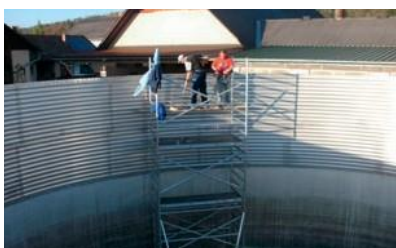
2. Kruhy na betonové nádrži 2. Ring on concrete tank
