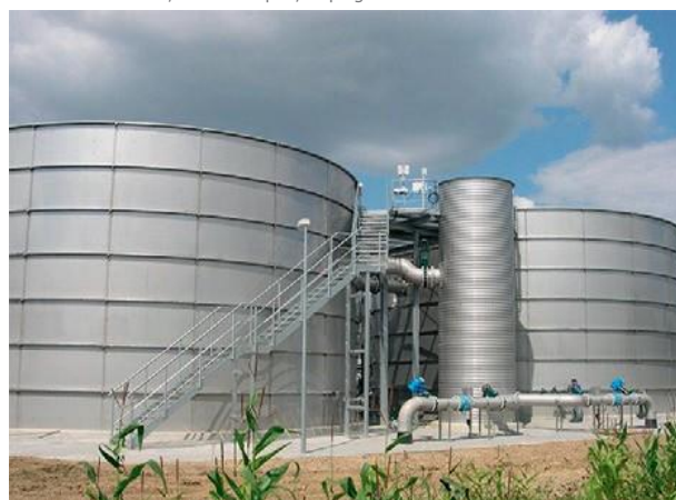
1.664 m 3 hladká nádrž a 51 m 3 z vlnitého plechu pro papírenský průmysl 1,664 m 3 Stainless steel tank and 51 m 3 corrugated steel tank in the paper industry
