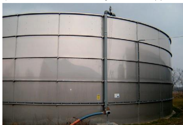
Sací a plnicí stanice přes hranu nádrže Suction and filling station above tank edge
