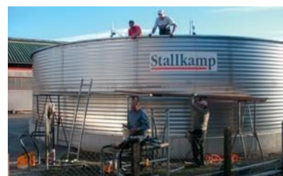
Zvýšená betonová nádrž Heightened concrete tanks
